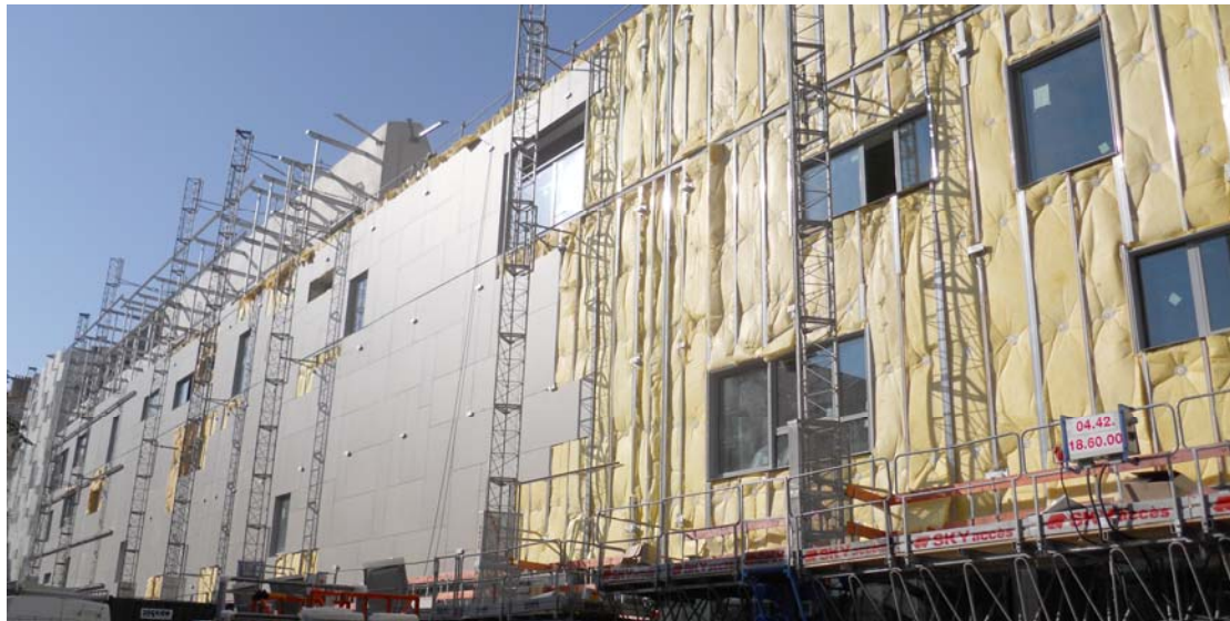
Figura 3. FRAC - Fonds Régional d'Art Contemporain, progetto Kengo Kuma et Associates. Foto del cantiere: messa in opera di rivestimenti e pannelli coibenti.
