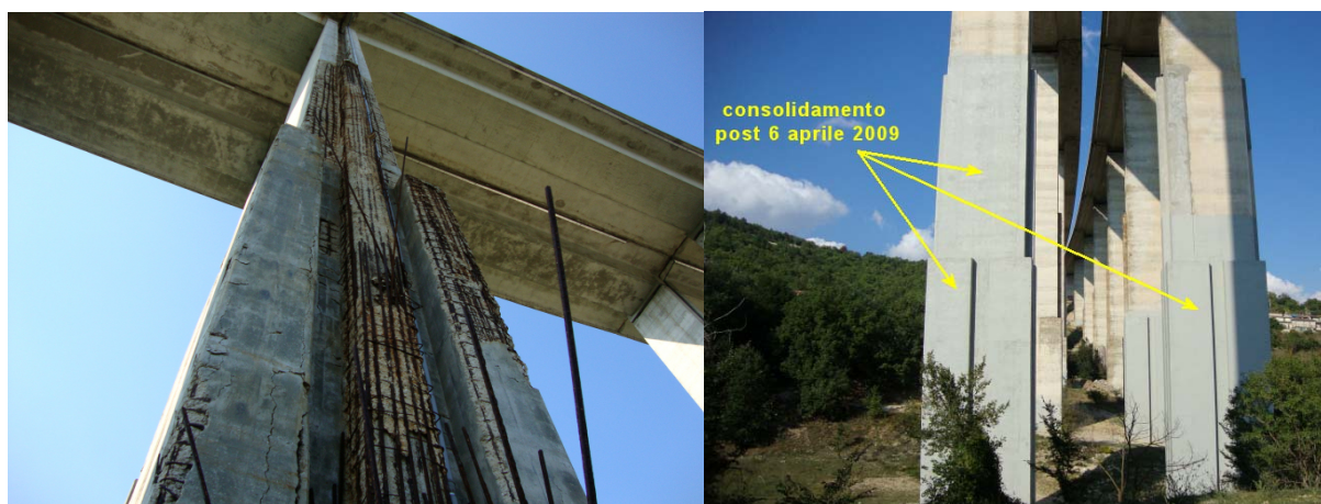
Figura 2. Lo stato dei manufatti autostradali A24/25 alla data del 7 aprile 2009
